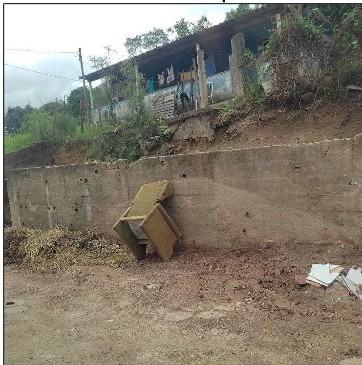
Figura 63 – Acondicionamento inadequado de resíduo volumoso.
